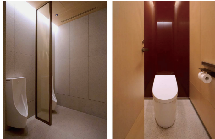
18Fメインロビー 男性トイレ 小便器・大便器コーナー
