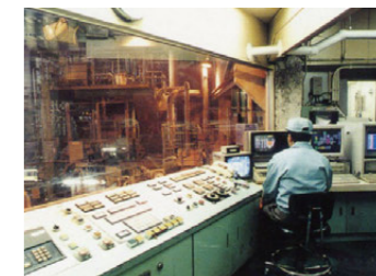
モデル工場 鑄造Vプロライン・コントロール室
